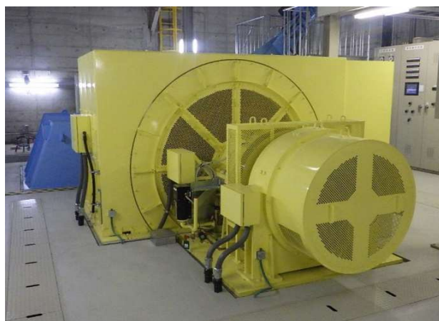
発電機 更新後
